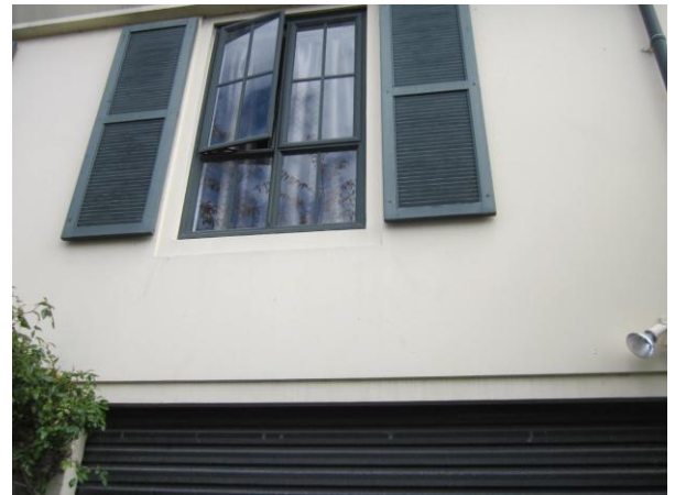
Crack above garage door
